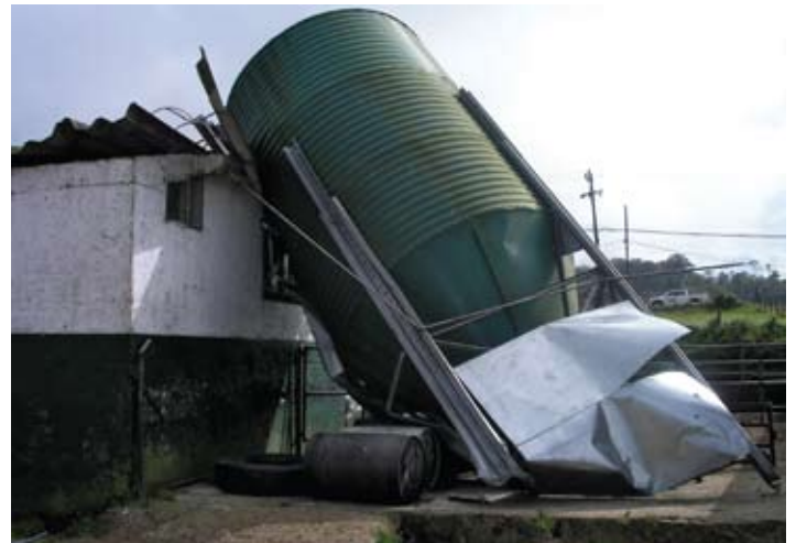
Tanque de melaza colapsado. Es evidente que estas estructuras fueron diseñadas para condiciones no sísmicas probablemente típicas del país de origen.
