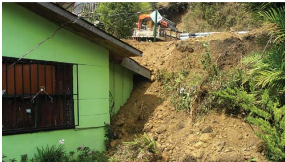
Empuje de tierra por deslizamiento del terreno superior.
