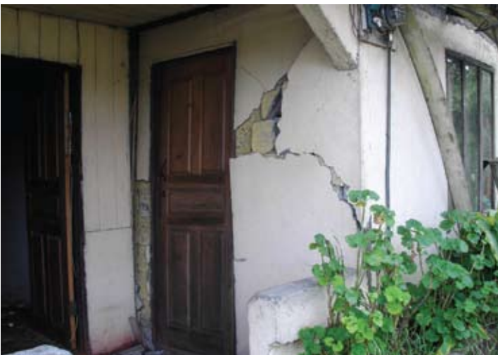
Grietas de cortante en un paño de mampostería sin refuerzo.
