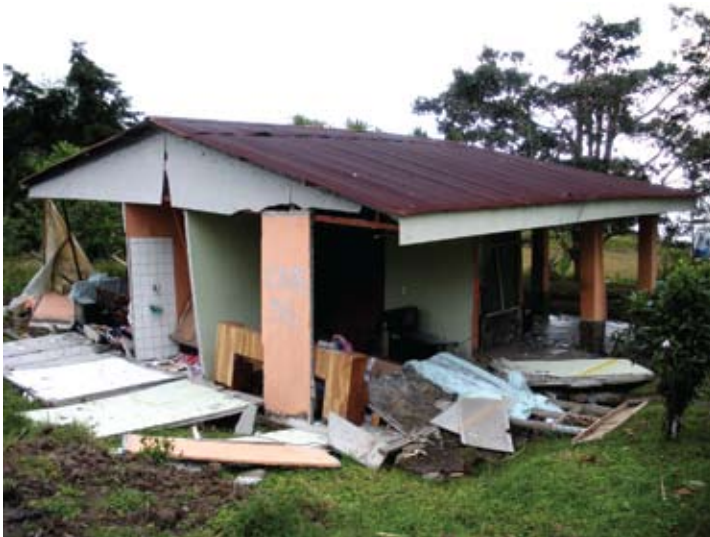
Falla en el sistema de paneles verticales, por falta de un amarre en la parte superior de las paredes
