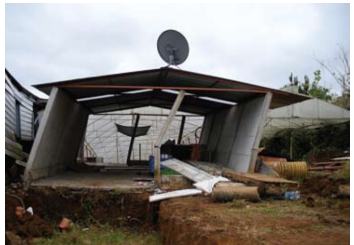
Estructura deformada lateralmente por la falta de rigidez en uno de sus ejes principales.
